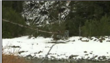
引湯パイプ落下
